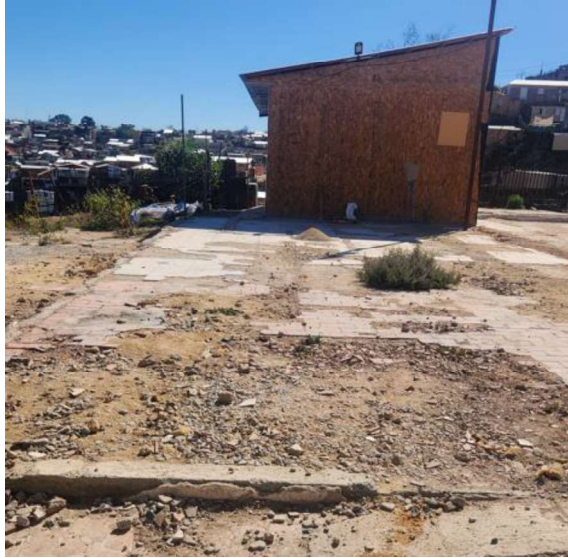
Imagen 1: Vivienda Rol [redacted] daño radier.
