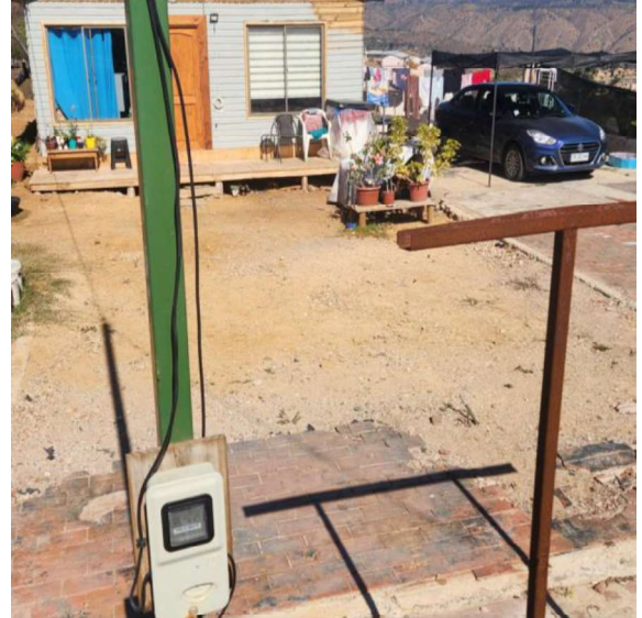
Imagen 2: Vivienda Rol [redacted] daño radier.
