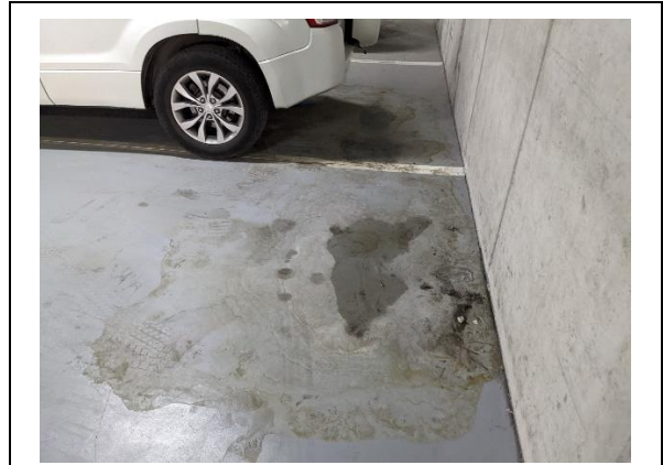
Fotografía N° 2: Acumulación de agua producto de las filtraciones en la losa del subterráneo.
