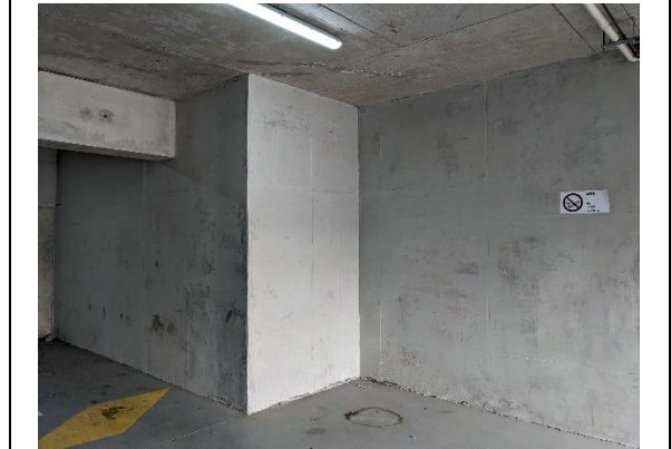
Fotografía N° 4: Filtraciones en la losa del subterráneo y acumulación de agua.
