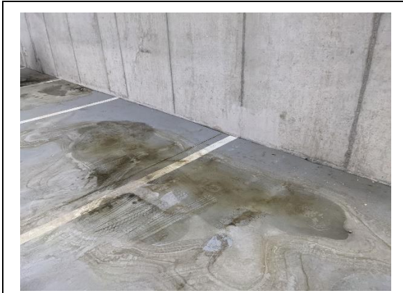
Fotografía N° 1: Acumulación de agua producto de las filtraciones en la losa del subterráneo.
