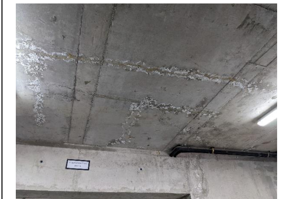
Fotografía N° 3: Filtraciones en la losa del subterráneo.
